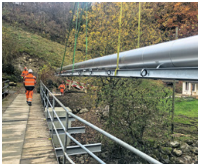
Tuyaux isolés de Wild sur la traversée du lit de la rivière.
