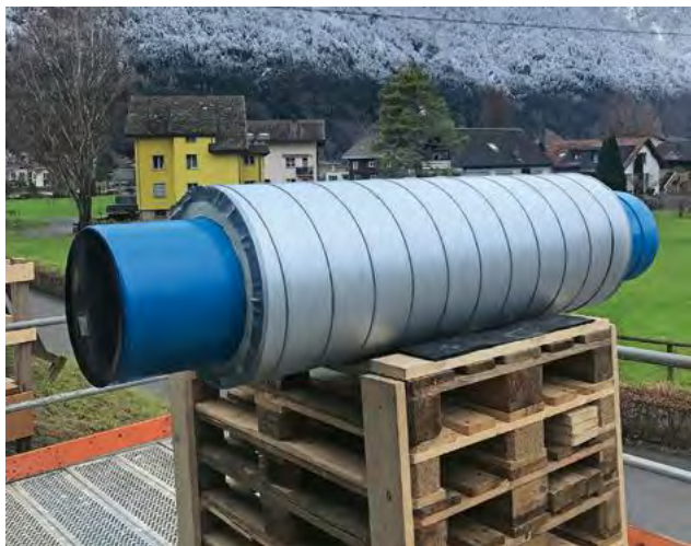
Das wärmedämmte Gussrohr, im Kompetenzzentrum Eglisau von Hagenbucher auf Mass gefertigt.
