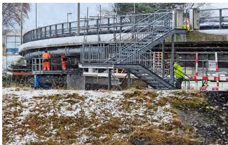
Dank der Auslenkungen von bis zu 4° war es möglich, den engen Radius der Reussbrücke ohne Formstücke zu bewerkstelligen. Die Leitung wurde auf der gesamten Länge formschlüssig schubgesichert.
