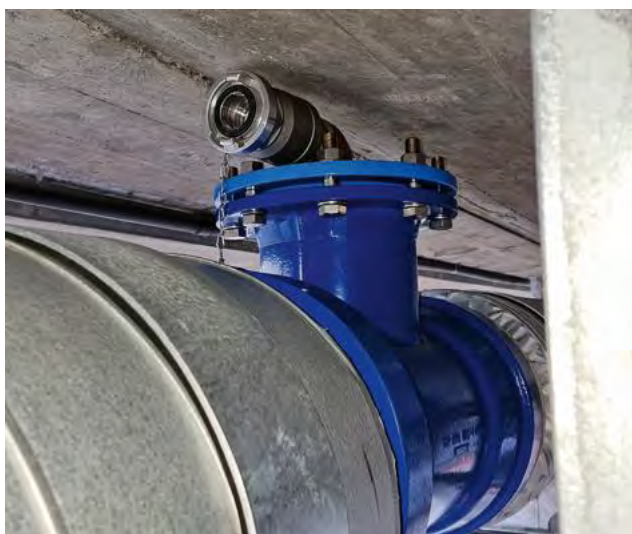
Entlüftungs-T-Stück mit Blindflansch und Kugelhahn.
